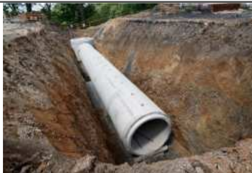
Podzemní retenční dešťová nádrž – trubní retence, Kralovice
