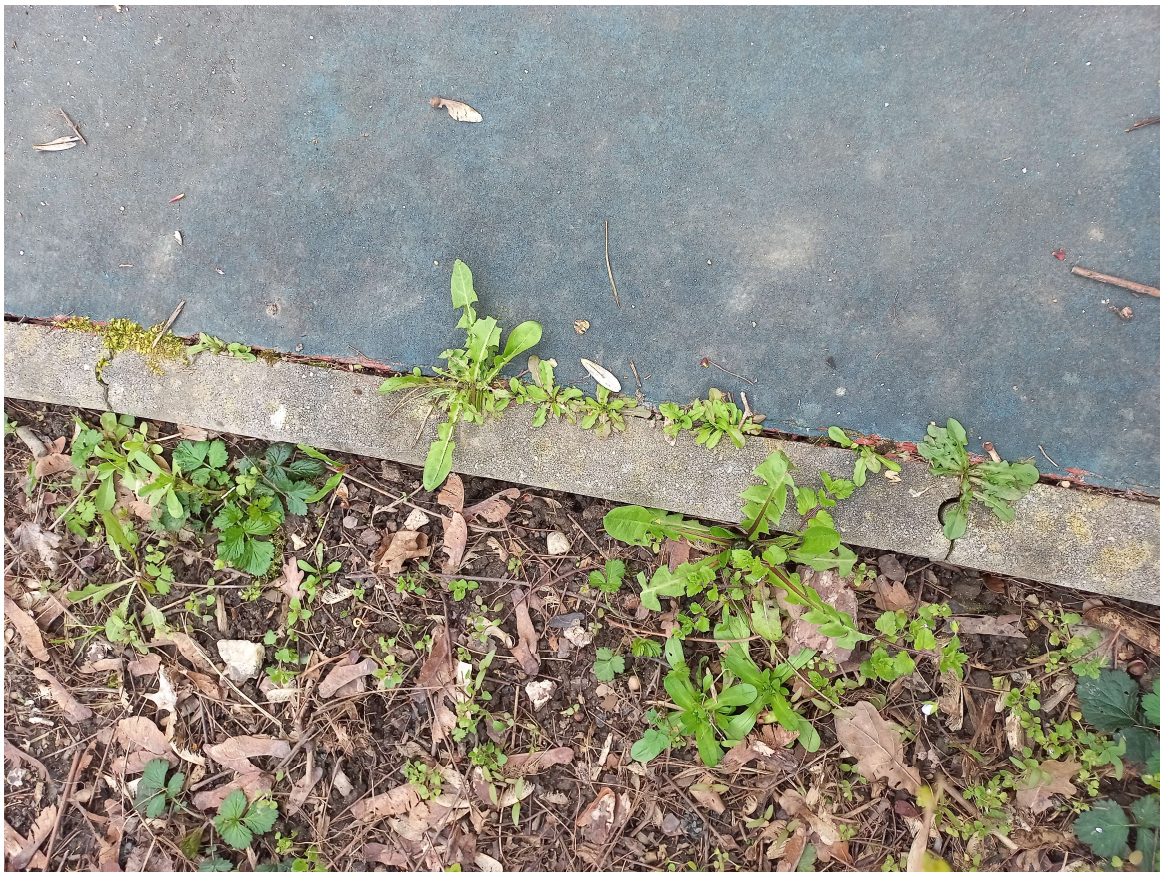
PRORŮSTÁNÍ MECHU A PLEVELE MEZI DRÁHU A OBRUBNÍK
