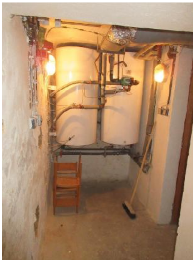
FOTO 11: Ohříváče vody ve výklenku v jihozápadní části chodby (za skladem)
