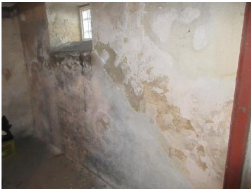
FOTO 5: Na severní straně sklepa je trvale otevřené okno
