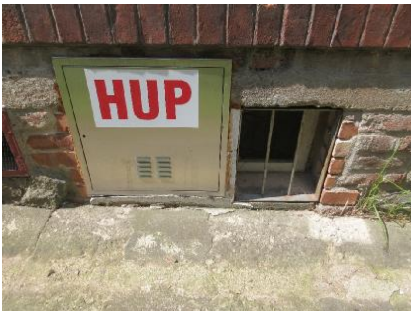
FOTO 4: Na východní straně je do okna vsazena skříň plynoměru
