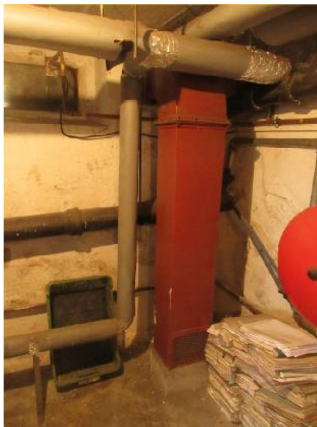
FOTO 7: Detail přívodu vzduchu a přívodu plynu
