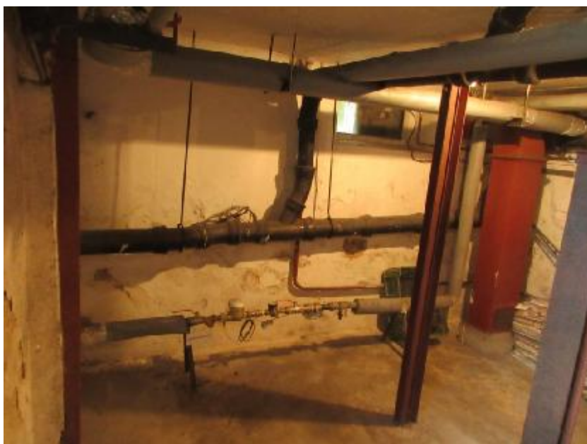
FOTO 6: Na východní stěně sklepa jsou umístěny instalace a vzduchotechnické potrubí přívodu vzduchu pro plynový kotel
